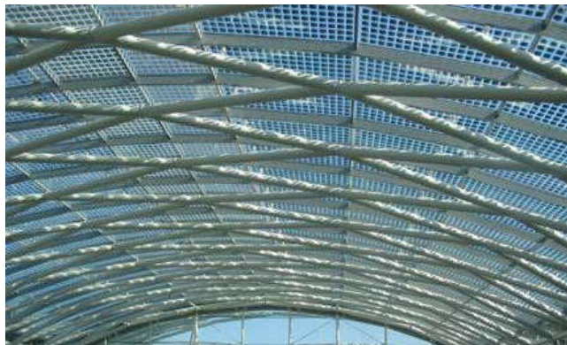
Slika 6 – Izgled fotonaponskog panela postavljenog na stakleni krov
