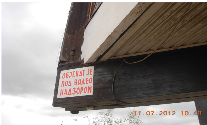
Slika 3. Imperfekcija ugaonog veznog stuba i nagnječenje izazvano oslanjanjem durisol-panela o nosač od LLD
