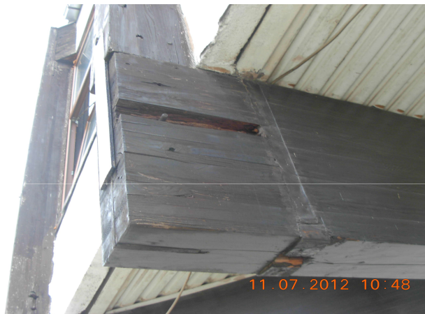
Slika 4. Konzolni nosač u pravcu B-B sa jasnim oštećenjima, izmenom geometrije veze i okom vidljivim ugibom
