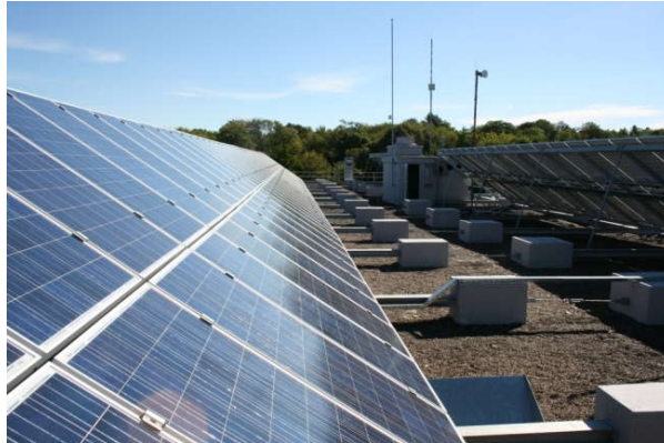
Slika 5 – Izgled fotonaponskog panela postavljeno na ravan krov
